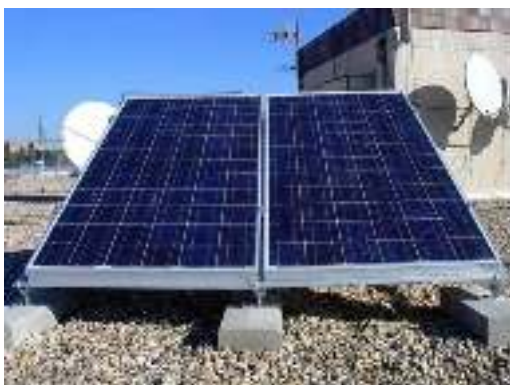
Солнечные фотоэлектрические модули
